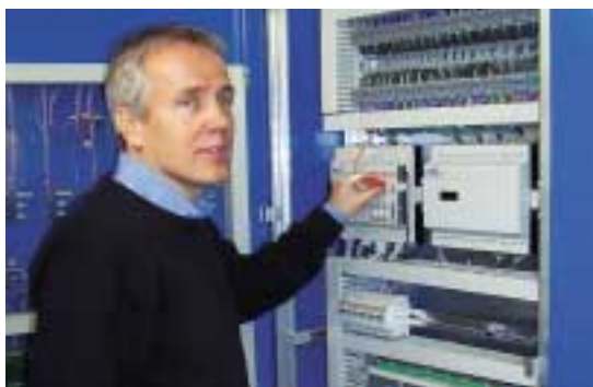
D. Zucko, Gebäudesystem-Techniker von Burkhalter AG, Zürich, vor einem Schaltschrank mit EIB- und SPS-Komponenten. (Bilder: Bus-House)
