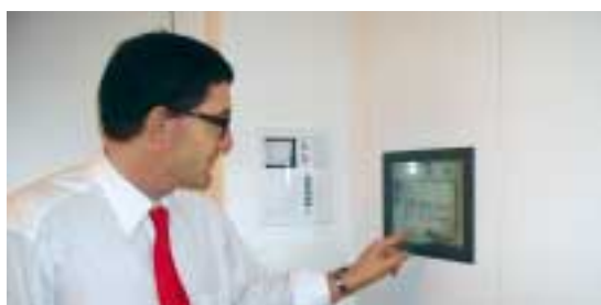
Herr Käser am zentralen Touch-Panel für die Bedienung der gesamten Beleuchtung und Beschattung (Bild: Bus-House)
