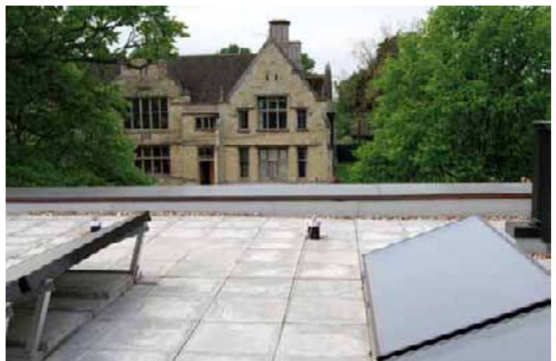
Nachhaltige Ressourcen: Solarkollektoren für das Brauchwarmwasser.
