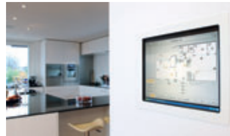
Das Touchpanel im Esszimmer ist das Cockpit für den Hauspiloten.
