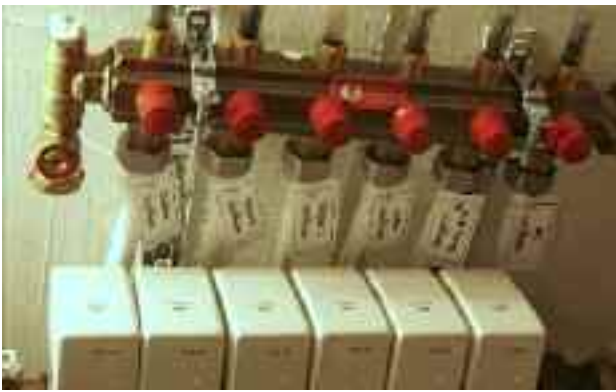
Les vannes de régulation permettent un réglage fin de la température.
