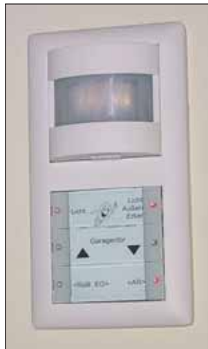
Bild 3. Bewegungsmelder dienen als Sensoren der Lichtsteuerung und der Alarmanlage / Figure 3. Motion detectors function as sensor for the lighting control and the alarm system.
