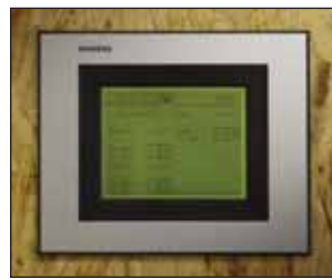
Bild 4. Die zentrale Steuerung der Gebäudesystemtechnik befindet sich gut geschützt im Technikraum.
