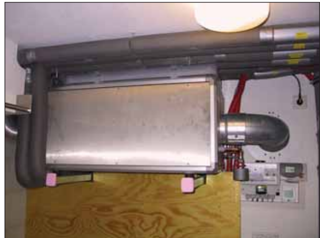
Bild 1. Die Luft/Wasser-Wärmepumpe gewinnt aus der Abluft Energie für die Warmwasseraufbereitung / Figure 1. The air-water heat pump withdraws energy from the exhaust air stream for the heating of domestic water
