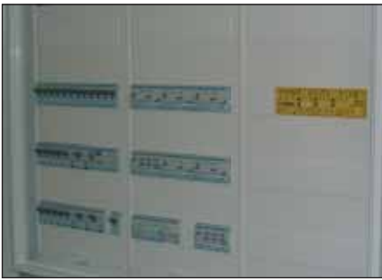
Bild 2. KNX Komponenten in der zentralen Wohnungsverteilung Figure 2. KNX components of the central apartment distribution
