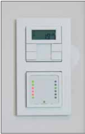
Bild 2. KNX Multifunktions-Bediengerät in den Wohnräumen: Temperaturfühler, Display, Taster für Beleuchtung und Beschattung, LED-Anzeige für Überwachung Figure 2. KNX multi-functional operating panel in the rooms: temperature sensor, display, button for lights and shading, LED display
