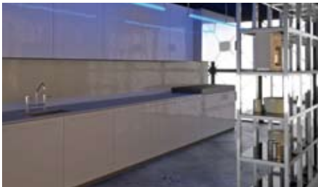
Vérification centralisée de tous les consommateurs électriques essentiels en sortant du bâtiment
