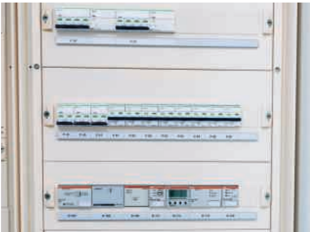
Ensemble d'appareillage avec composants KNX et passerelle BACnet
