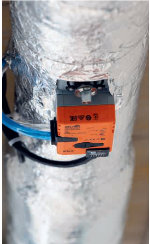
CVC ne pose aucun problème à KNX: un régulateur de débit commandé par KNX assure l'échange d'air agréable dans les bureaux.
